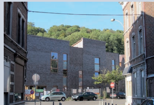
Le projet des Z'urbains à Liège (en cours de construction) vise le standard basse énergie également grâce à l'isolation renforcée des parois et à la mitoyenneté.
