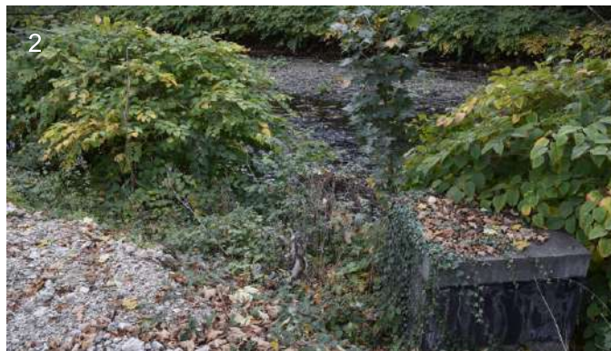
Renouée du Japon et une chambre de visite
