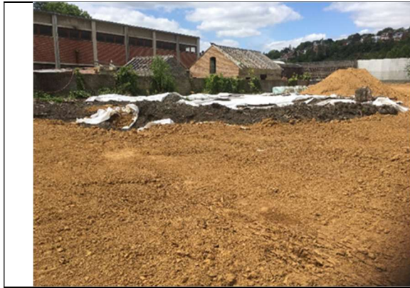
Photographie 30: confinement atour de la zone amiantée le 12 mai 2020
