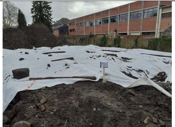
Photographie 6: zone amiantée recouverte d'un géotextile
